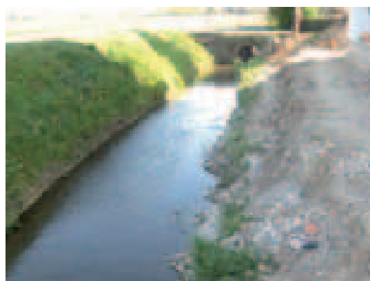
A csatorna partoldala nyilvánvalóan leomlott és helyreállításra szorult, már csak azért is, mert a megrendelőnek biztonságosan járható közlekedőútra volt szüksége a csatorna partján.
